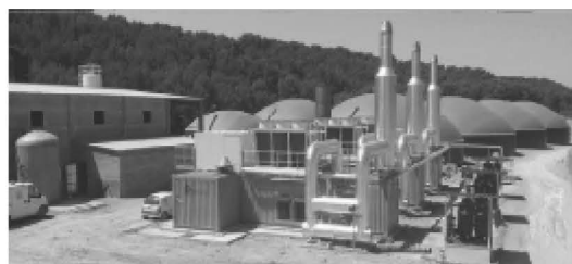
Figura 13. Planta de biogás de Almenar, Segrià.
